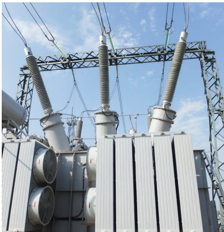
“莫斯科绝缘”公司生产的，干线电网变压器上的 330 kV 套管
