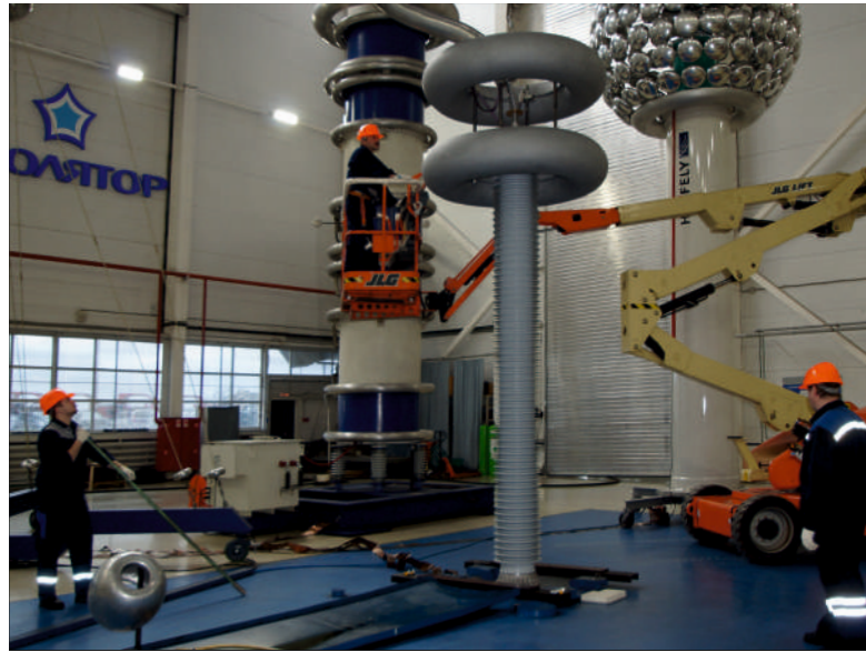
图 34. “莫斯科绝缘” 厂内220-1150kV 套管试验区域
