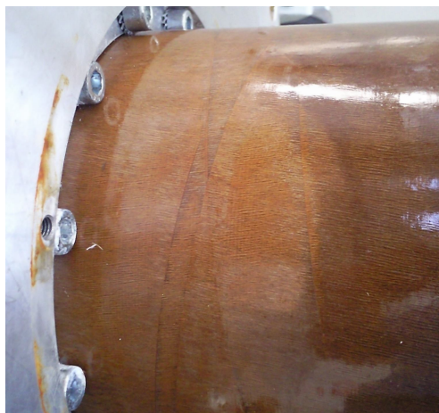
Рисунок 2 – Поврежденная водой поверхность ввода с RIP-изоляцией.
